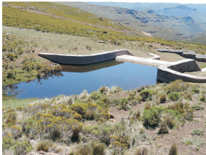
Des gabions après les pluies
